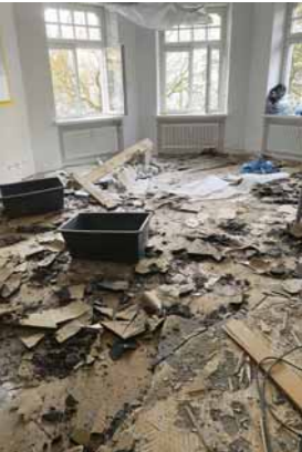
Deutliche Spuren: Die Behebung der Wasserschäden machte ungewollt eine Sanierung der Geschäftsräume notwendig.
